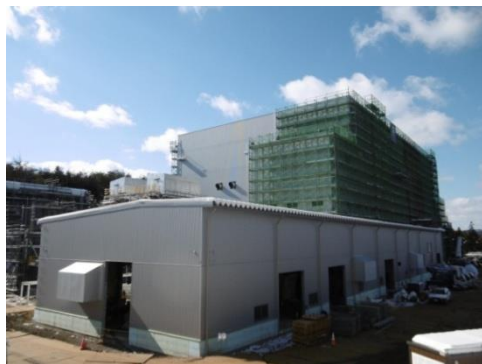
写真 鶏糞バイオマス発電所
