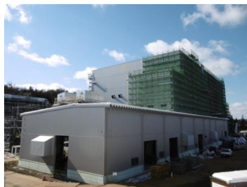
写真 鶏糞バイオマス発電所
