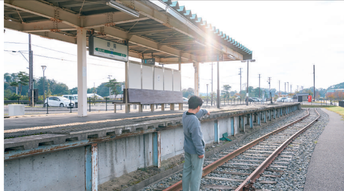
地震によってゆがめられた線路。災害危険区域となった野蒜では2700世帯が高台に集団移転しました。
