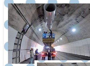
トンネル内の換気設備「ジェットファン」の設置工事も行っています
