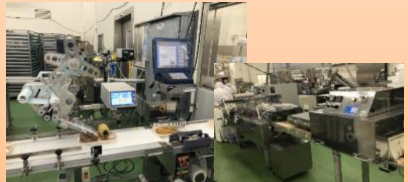
グループ補助金を活用して整備された 水産加工施設内の設備の事例(塩竈市)
