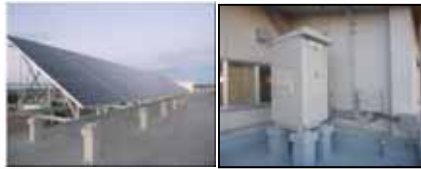
2011～2015 市中核避難所に整備した PVと蓄電池(GND)
